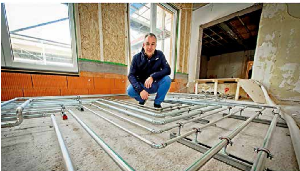
Lars Böttger – er ist mitverantwortlich für die Planung – hockt inmitten von Rohren im ehemaligen Möbelmarkt hinter dem Hotel. Foto: Daniel Volkmann
